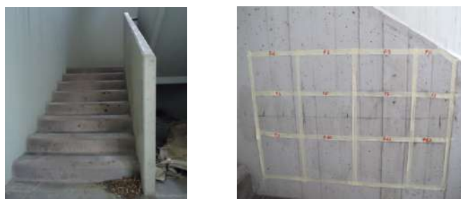
Figg.1 - 2: Parapetto in calcestruzzo oggetto di indagine; individuazione dei punti di misura
